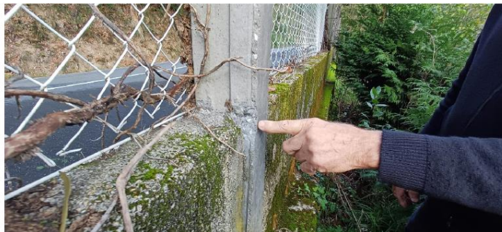
Foto 11: Detalle poste nº 5, fracturado.
