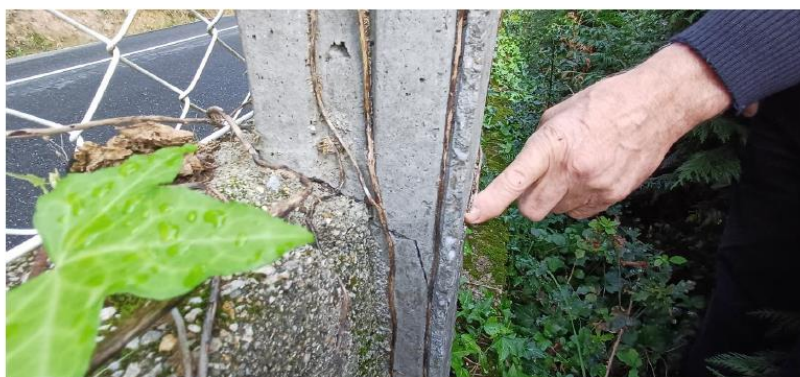
Foto 8: Detalle poste nº 2, fracturado.
