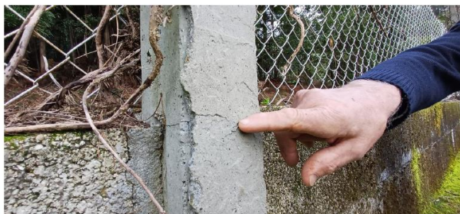
Foto 9: Detalle poste nº 3, fracturado.
