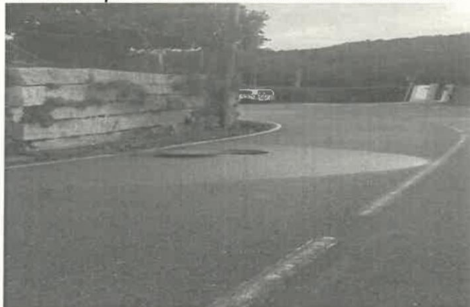
Foto 04.- Vista tapa alcantarilla desde carril descendente
